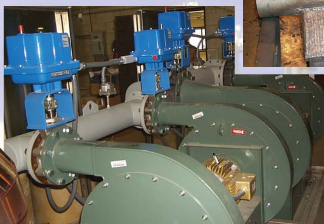
Fan Skid w/Auto Shutoff
